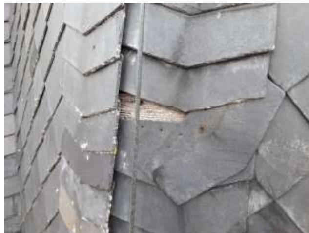
Eine der vielen losgelösten Schieferdachschindeln
